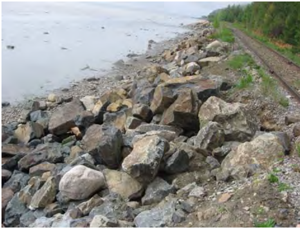
3. Érosion au point milliaire 32,2
