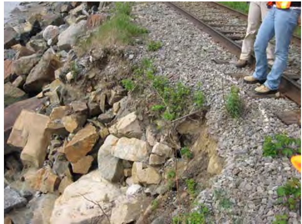
2. Érosion au point milliaire 32
