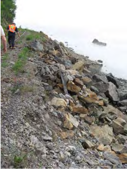
1. Érosion au point milliaire 30,8
