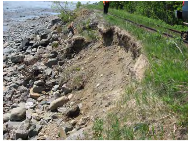
4. Érosion au point milliaire 47,5
